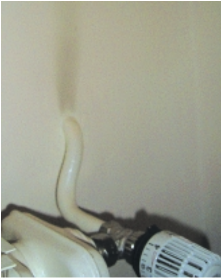
Übliche Fogging-Quelle: Staubverschmelzung am überhitzten Heizkörper. Typisch: die Schwarzstaub-Fahne über der Zuleitung.
