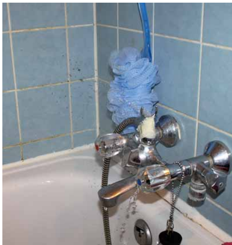
Linke Seite: Das eingerüstete Haus am César-Klein-Ring. Oben: Armaturen wie diese sind in dem Mietobjekt leider keine Ausnahme. Links: Der Zugang zum Haus wird durch die Baustelle erheblich erschwert. Fotos: stahlpress/Warda.
