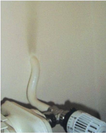
Übliche Fogging-Quelle: Staubverschmutzung am überhitzten Heizkörper. Typisch: die Schwarzstaub-Fahne über der Zuleitung.
